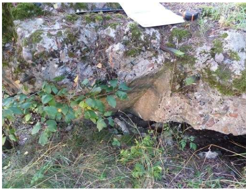
Fot. 05. Kanał technologiczny na rury łączności świetlnej w schronie Mątewica. Fot. Łukasz Drzensła.
